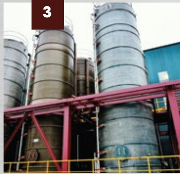
NHÀ MÁY TÁI SINH AXIT ACID REGENERATION PLANT
